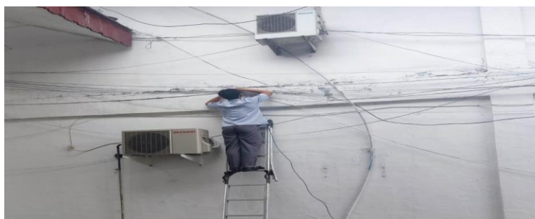
Gambar 3 jaringan kabel LAN di dinsos
